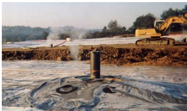
Dégazage des puits d'événements reliés aux bandes Teradrain
